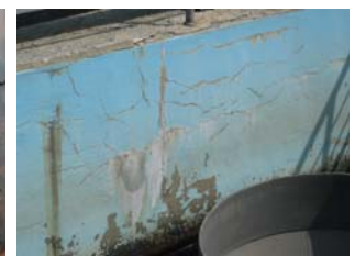
방식층 균열 및 수산화칼슘 용출
