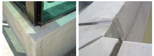
진동 및 거동으로 균열 발생
