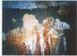
사진 1. 누수 및 철근 부식발생 (내구성 저하)
