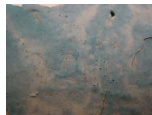
방식재 균열 및 열화
