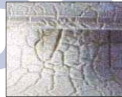
절연파괴로 균열이 생긴 모습
